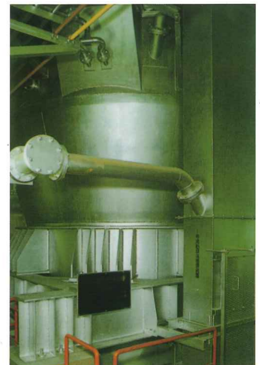
● 焼却炉 自動燃焼制御装置によって、常に最適な状態でごみを完全焼却します。
