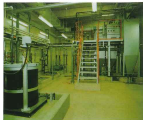
● 排水処理設備 場内排水は場外に放流せず、凝集沈殿ろ過処理を行ない、きれいな水にして再利用します。
