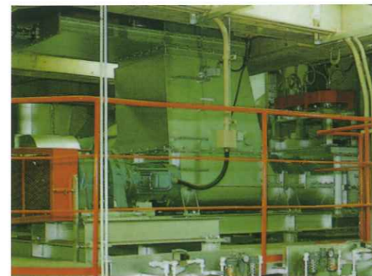
● 給じん装置 2軸のスクルーによって、ごみを安定、かつ連続的に焼却炉へ送ります。
