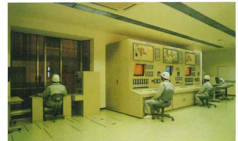
●中央制御室 工場全体の頭脳にあたる「中央制御室」には、すべての機器の運転状況を示す計器類が集められ、集中監視と遠隔操作で的確な運転を行います。
